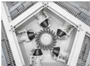
Turbine et injecteurs de la centrale de Navizence
