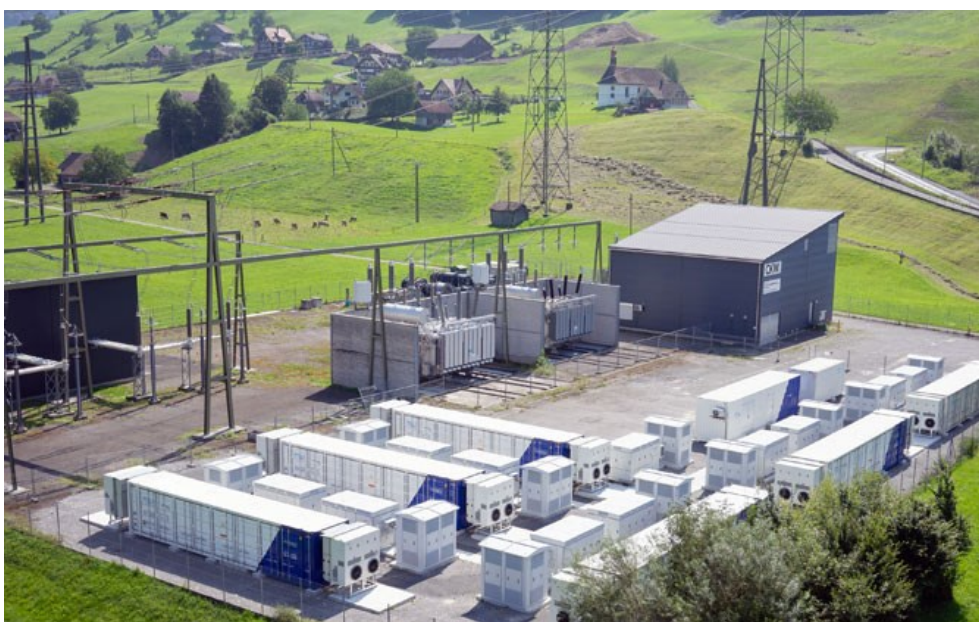
Der Batteriespeicher in der Innerschweiz hat eine Leistung von 20 MW.
