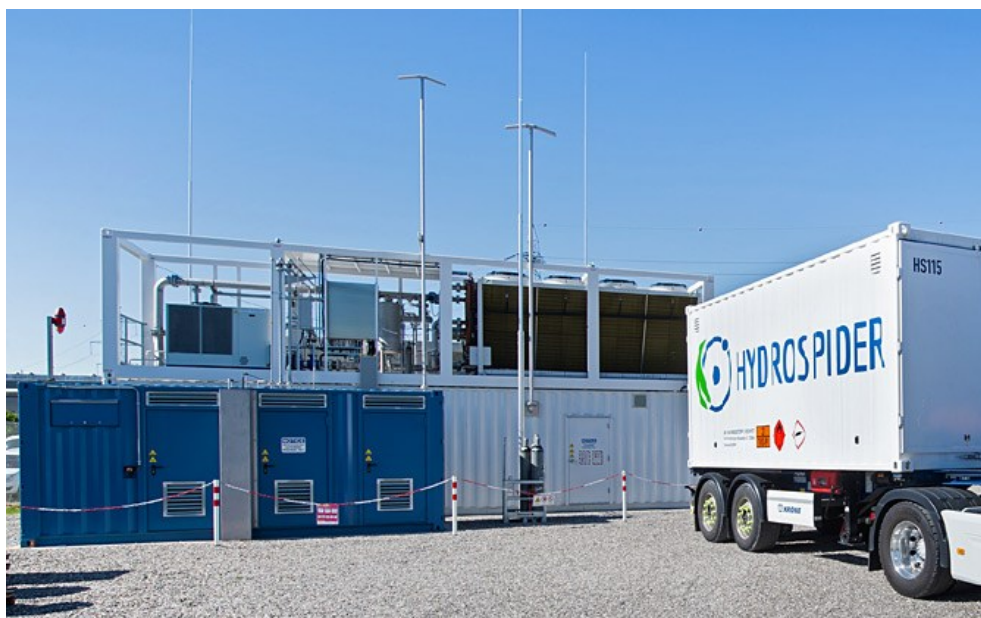
Die Elektrolyseanlage produziert Wasserstoff mit Strom aus dem Wasserkraftwerk Gösgen. Foto: Jean-Luc Grossmann
