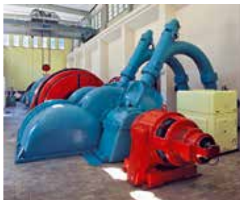
Salle des machines de la centrale de Mottec
